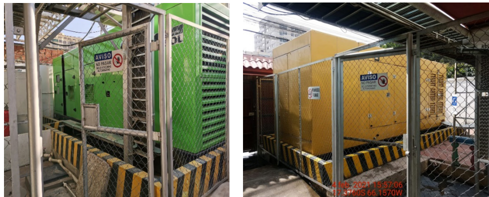
Imágenes 2 y 3: Grupos generadores - Data Center
